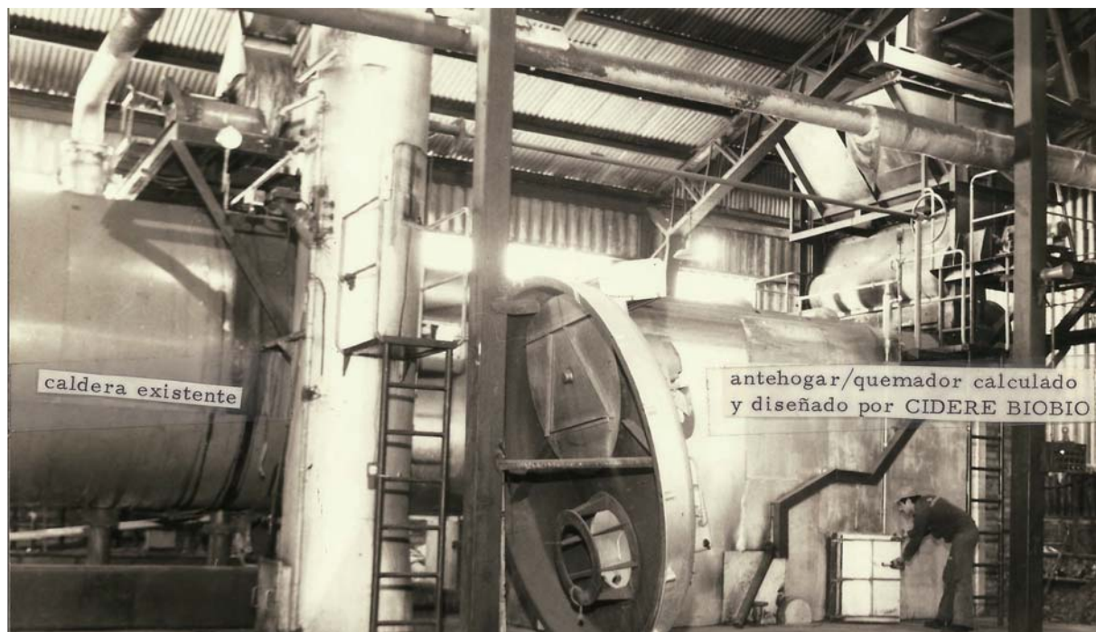
Uno de los antehogares quemadores de mayor tamaño diseñado por Cidere fue el que funcionó en la caldera de la fábrica de harina de pescado Tamarugal, en Talcahuano.
