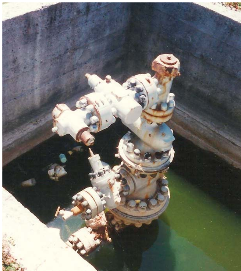
Las válvulas permanecen cerradas desde que finalizaron las faenas, a fines de la década de los años setenta.
