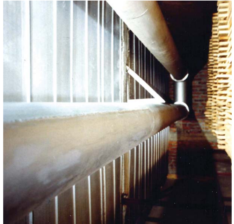
Vista parcial de los ductos.
