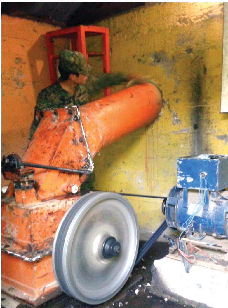
La microcentral hidroeléctrica Los Barros, implementada por Cidre Biobio, aún se encuentra en funcionamiento.
