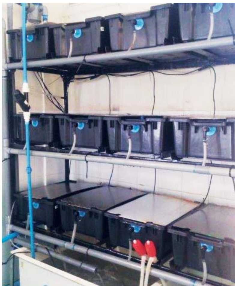
Con el financiamiento se pudieron adquirir estanques, bombas y un equipo de desinfección.
