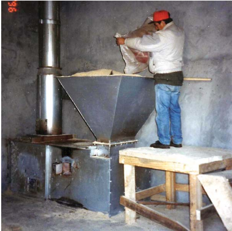
El quemador refractario de doble fogón fue diseñado y construido por Cidere.
